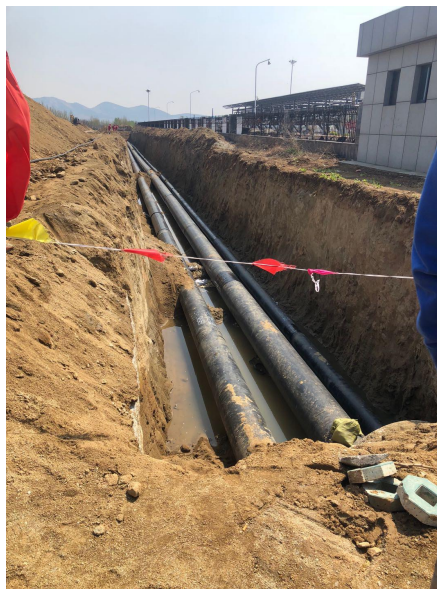
图 4: E 能源公司原油管道
